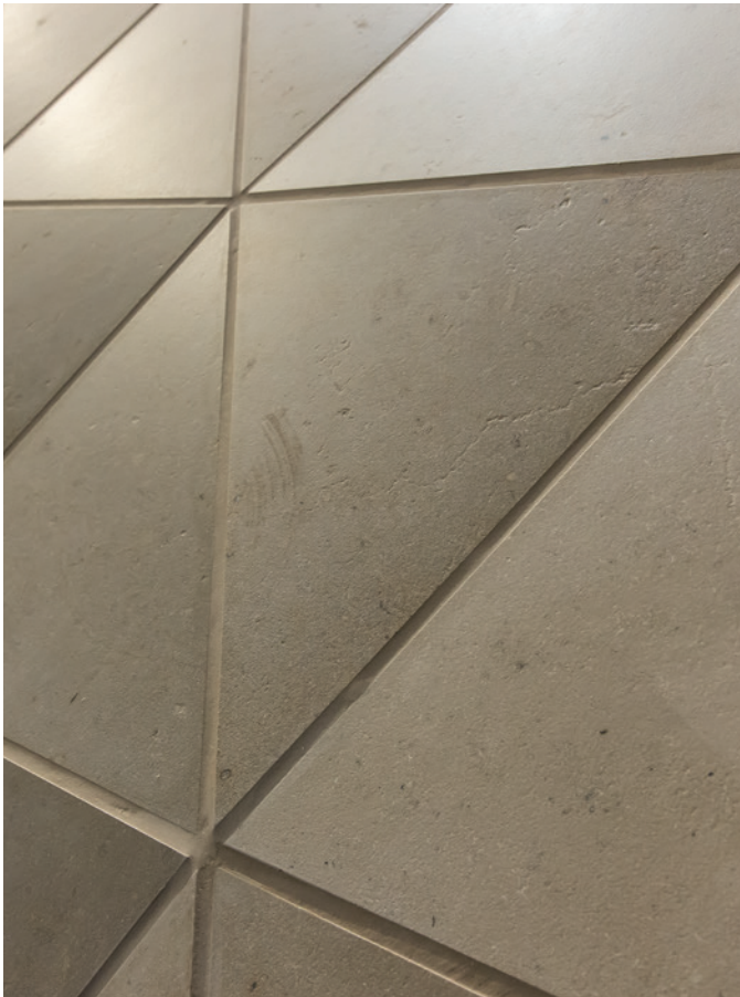
Detail der Natursteinfliesen als optimal zugeschnittene Bekleidung der Freiform, getönter Fugenmörtel als zusätzliches Gestaltungsmittel
