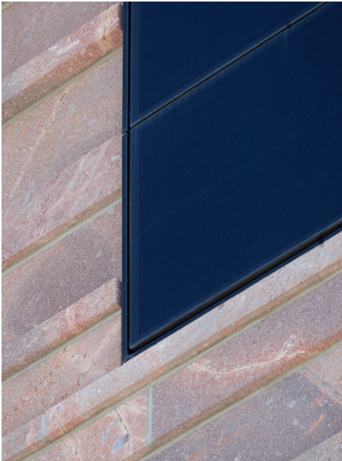
Detail am Übergang der nicht sichtbar befestigten Photovoltaik-Paneele zur Natursteinfassade
